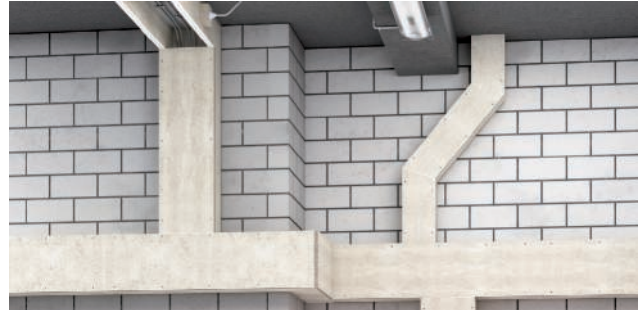
Goulotte coupe-feu montée au mur et au plafond
