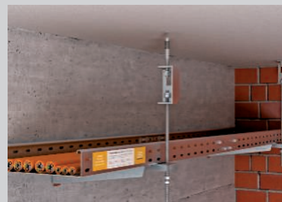
Fixation au plafond des tiges filetées avec étrier résistant au feu.
