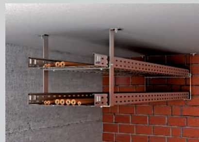
Montage au plafond sur deux niveaux avec étrier de suspension et étrier intermédiaire.
