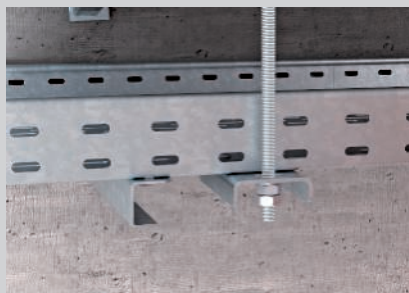
Fixation de la tige filetée verticale sur le chemin de câbles le plus bas.
