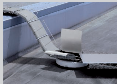
Utilisation sur des câbles photovoltaïques posés au-dessus d'un mur coupe-feu
