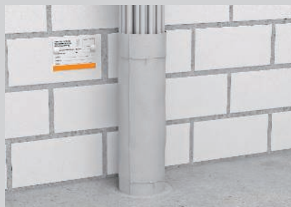
Boucher les trous du calfeutrement avec du mortier et monter la plaque d'identification.
