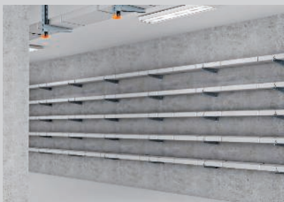
Tunnel de câbles avec enrubannage pour centrales électriques.
