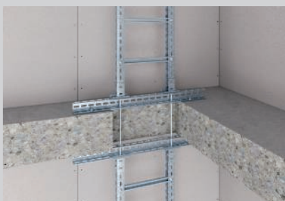
Montage de l'échelle verticale en continu sur une ouverture de plafond avec des profilés transversaux et des semelles.
