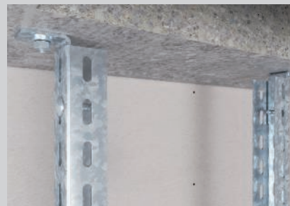
Fixation au plafond des montants de l'échelle avec des équerres de montage qui se vissent.
