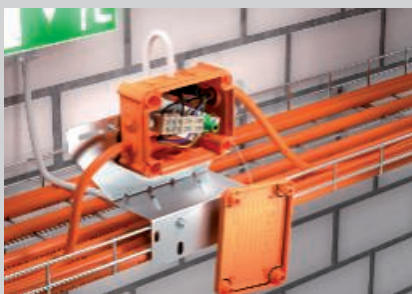
FireBox avec plaque de montage de type F montée à l'avant d'un chemin de câbles en treillis.
