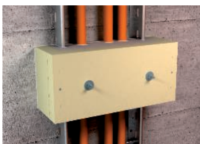
Installazione della compartimentazione cavi in combinazione con passerelle a scaletta
